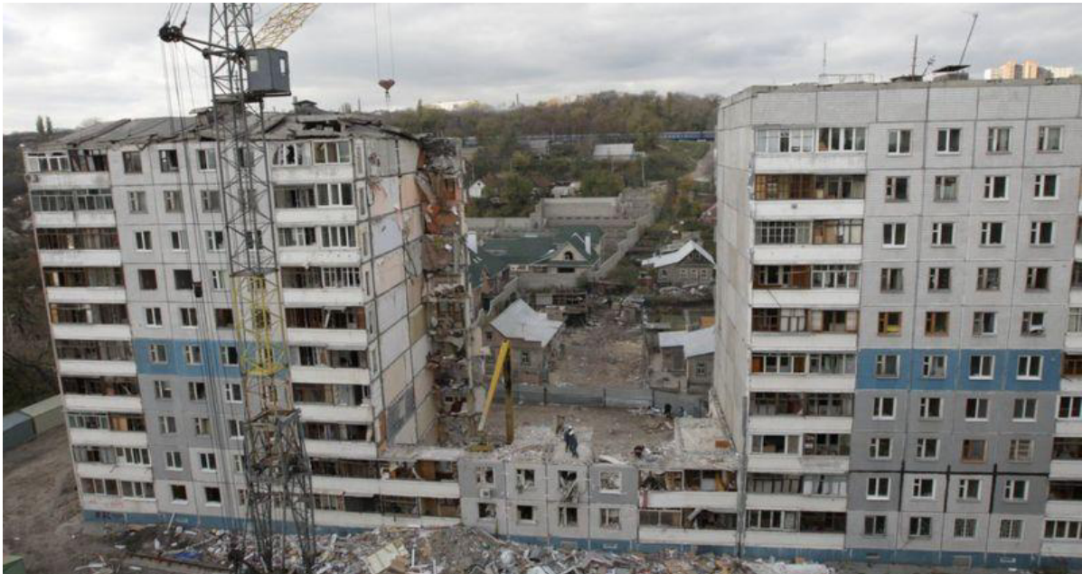
Рисунок 1 – Ефект прогресуючого руйнування панельного будинку в результаті вибуху газу
