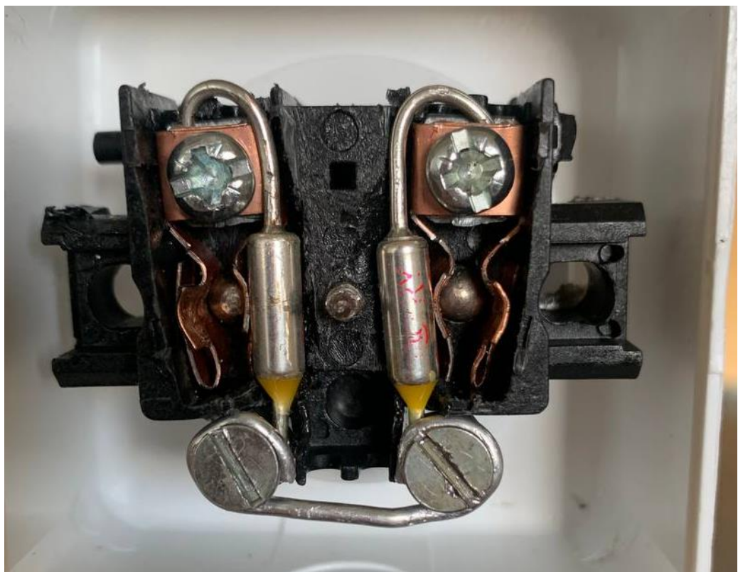
Рисунок 5.6. Вигляд обладнання, задіяного в експерименті (розетка з тепловим захисним елементом).
