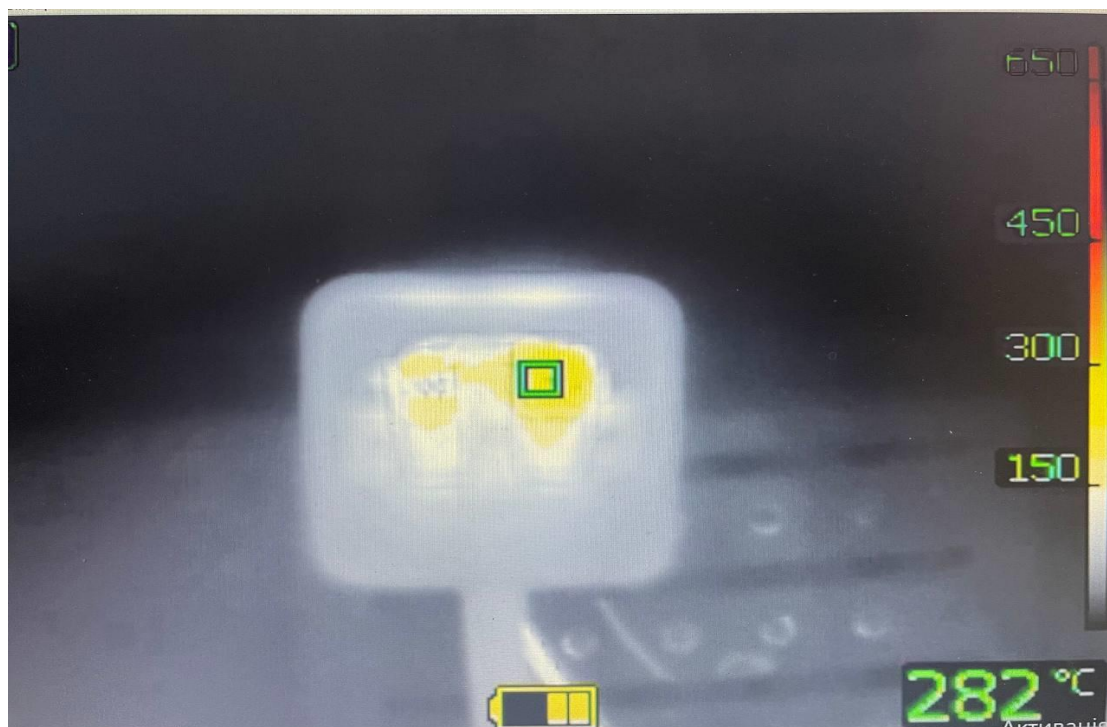
Рисунок 5.15. Розподіл температури в контрольному елементі електричного навантаження з окисленим штепселем та розігнутими контактними з'єднаннями розетки.
