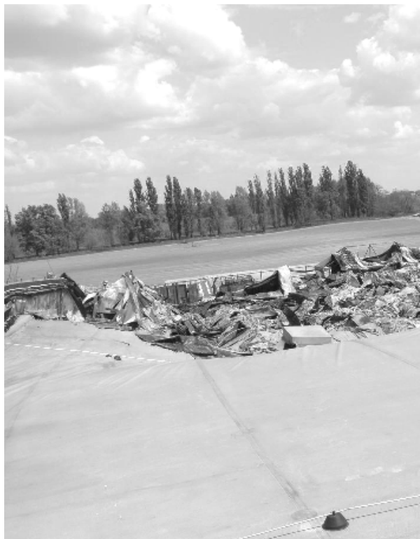
Рис. 3. Вигляд обвалених конструкцій будівлі в осях Г-Т (вигляд з покрівлі)
