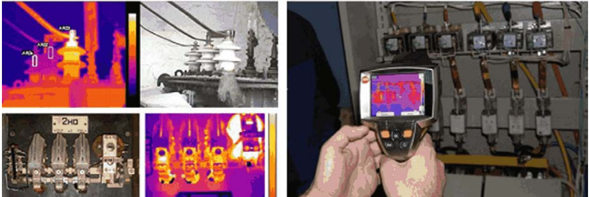
Рис. 18 Визначення стану електрообладнання за допомогою тепловізора
